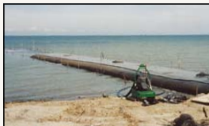
Systèmes TenCate Geotube® positionnés afin de créer un épi pour l'alimentation en eau d'un élevage de crevettes.
